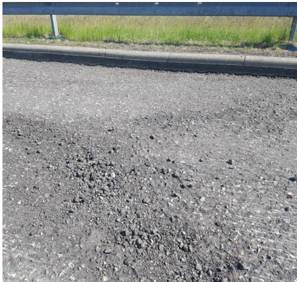
Bild 3: Ungeeignete Unterlage (Verschotterung)
